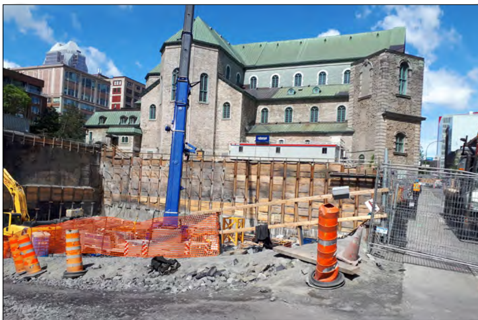
Vue du chantier au sud du Gesù en juin 2020, au moment de la manifestation des dommages.
