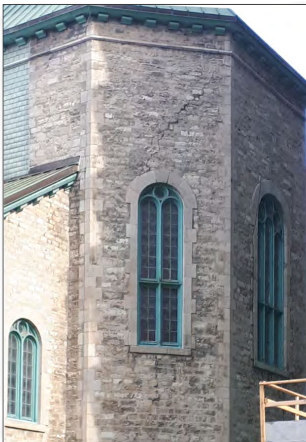
Lézardes sur la façade du transept sud du Gesù
